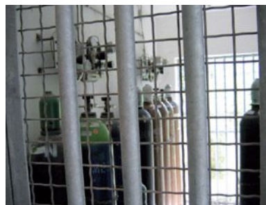
Abbildung 14: Gasentspannungsstation für Laborgase außerhalb des Laborraumes in einem gut gelüfteten Sonderraum
